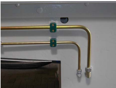
Neue, hochwertige Hydraulikleitungen
